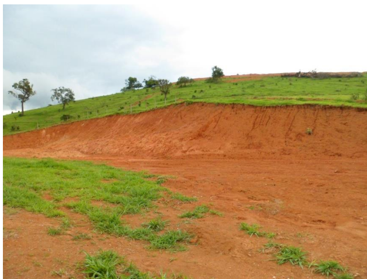
Figura 2. Alto escoamento superficial e risco de deslizamento. Fonte: MOREIRA, R.C.A., 2012.
