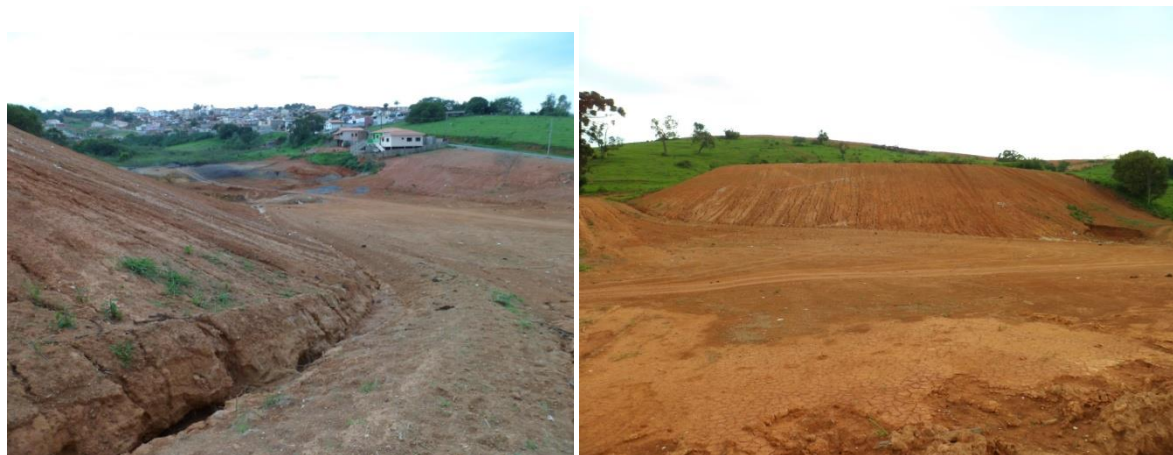
Figura 1. Obra urbana mal conduzida. Fonte: MOREIRA, R.C.A., 2012.
